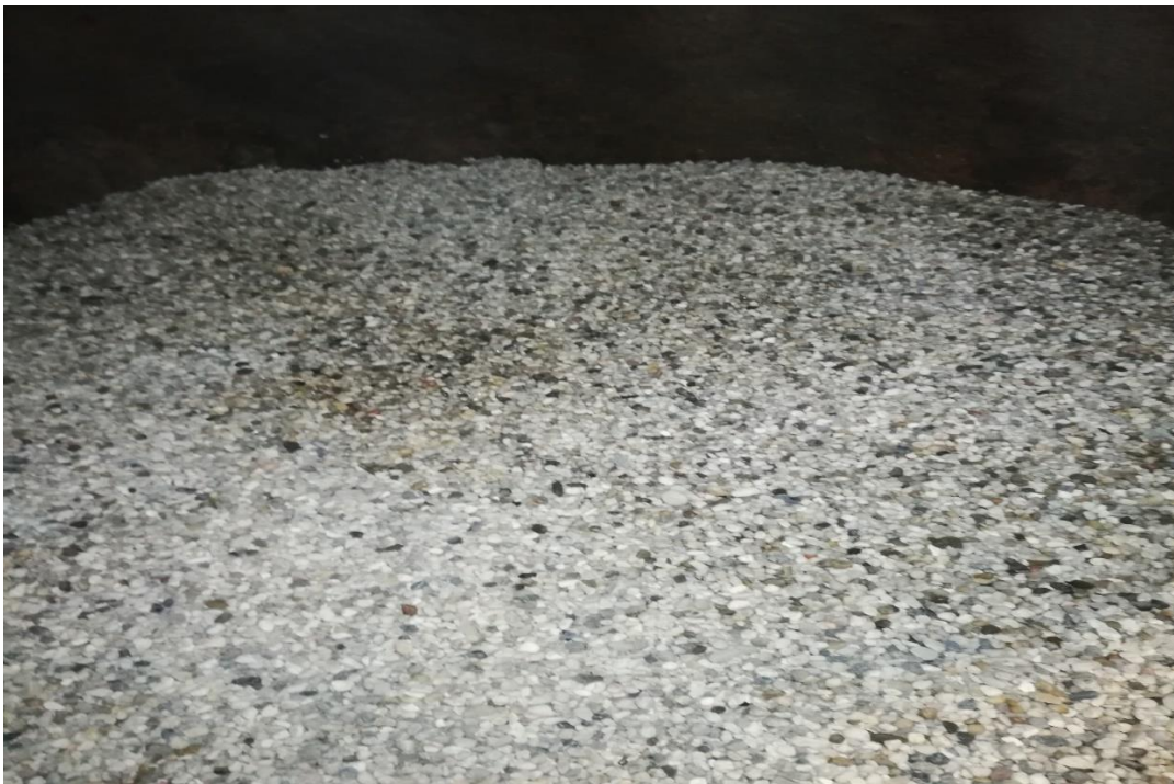
nowe żwirki – złoża filtracyjne
