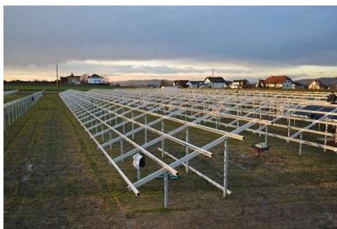
Fot. 16. Konstrukcje wsporcze ogniw fotowoltaicznych
